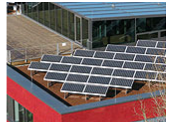
Detailansicht Dachterrasse mit PV-Anlage
